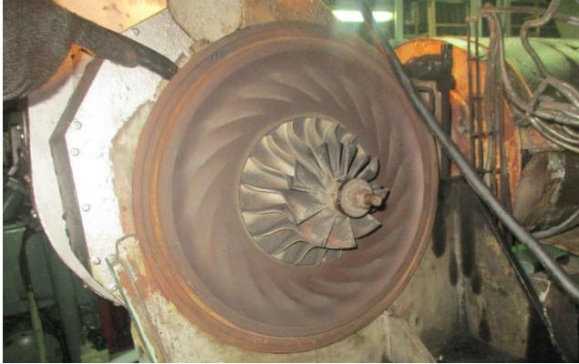
Gambar 4.1 Penumpukan kotoran pada kompresor
